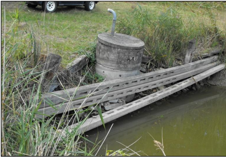
Figure 13: Effondrement du pompage DFCI et du remblai (E.Kim)
