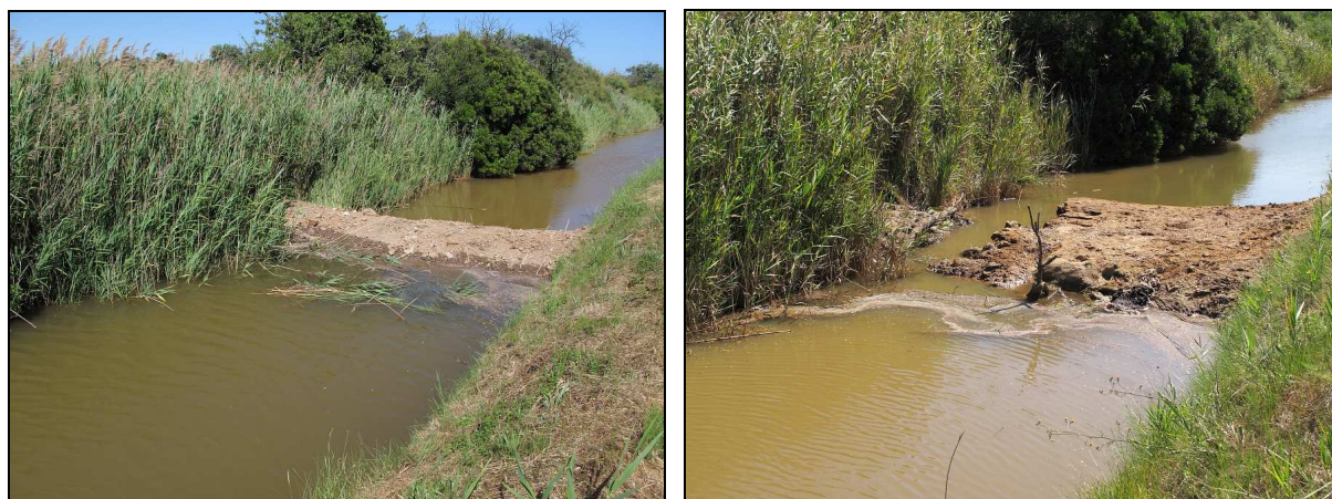
Batardeau venant d'être réalisé (à gauche) et détruit par l'eau quelques temps après (à droite)
