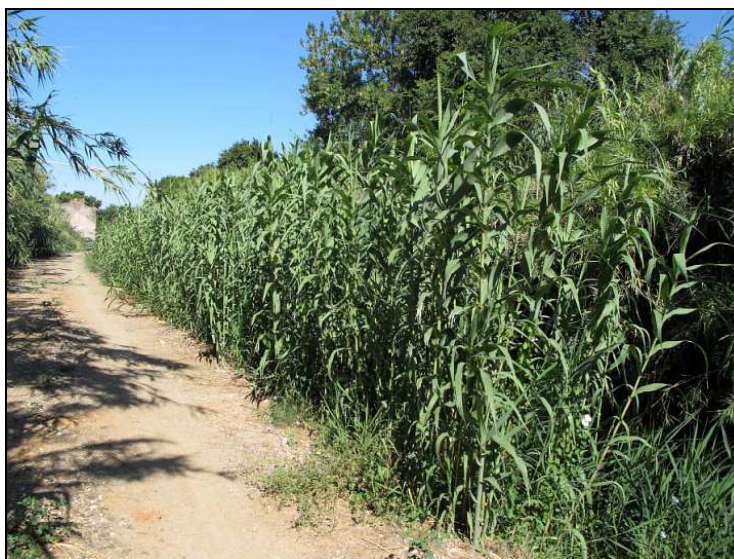
Végétation rivulaire faisant barrage à l'ensoleillement du canal
