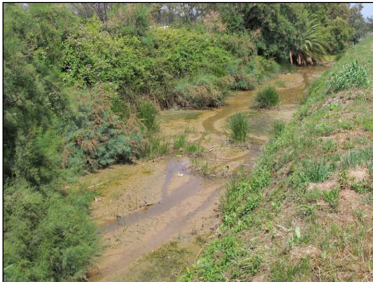
Partie du canal comblée par les sédiments
