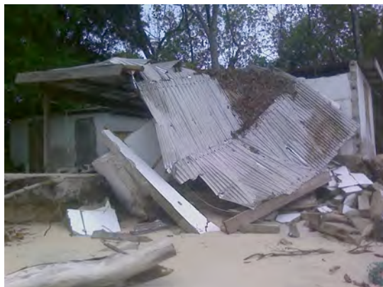
Fig. 2. - Habitation effondrée par l'action d'une houle de marée importante à Pointe Pongara (Gabon, septembre 2008), (phot. Marc Girondot).
