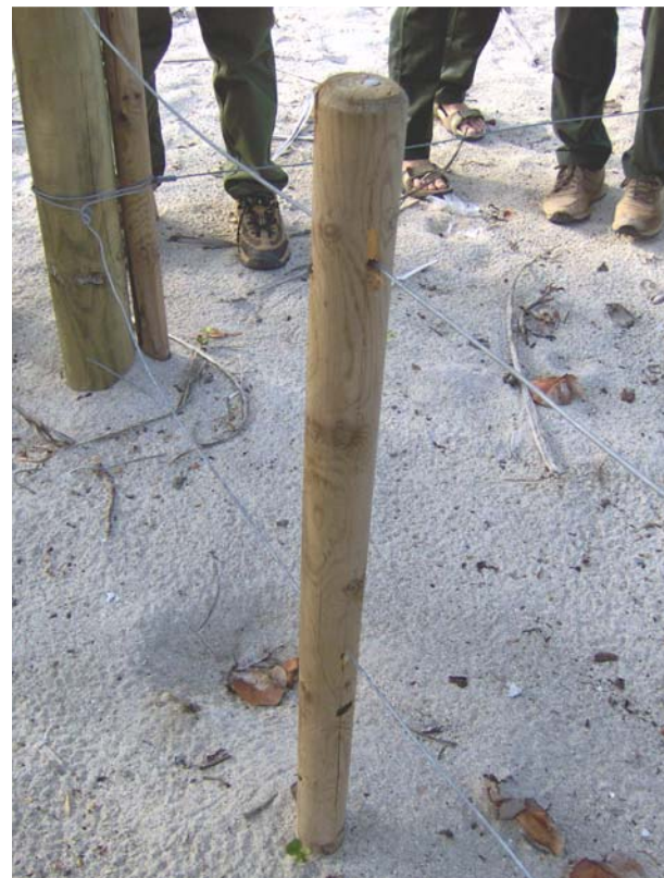
FDL Martinique, poteaux en pin traité, avec percements pour passage des fils. (Photo ONF Guadeloupe)
