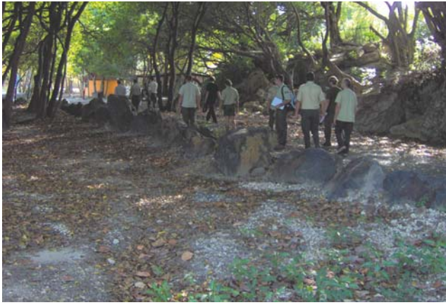
FDL Martinique, enrochement efficace, mais peu intégré à l'environnement ( Photo ONF Guadeloupe)
