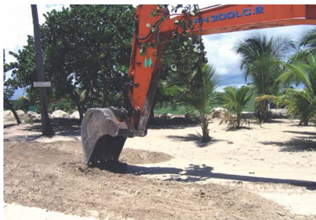
Bois Jolan - Décompactage fond de forme à l'aide d'une pelle mécanique. (Photo ONF Guadeloupe)
